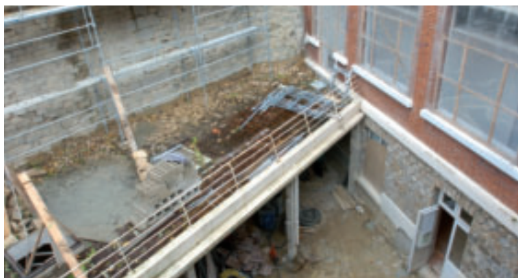
Les travaux de rénovation de l'Hôtel de ville se poursuivent. Rappelons que son accessibilité aux handicapés était l'un des objectifs prioritaires de ce chantier.
