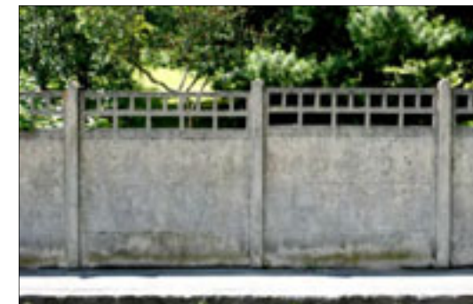
Clôture: Palissade béton NON AUTORISÉ A SEVRES (Sauf en réfection partielle)
