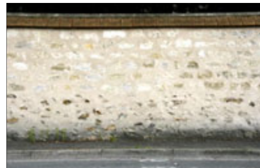
Mur de clôture en maçonnerie NON AUTORISÉ A SÈVRES (Sauf en réfection partielle)
