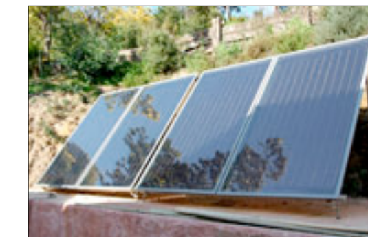
Panneaux solaires thermiques au sol
